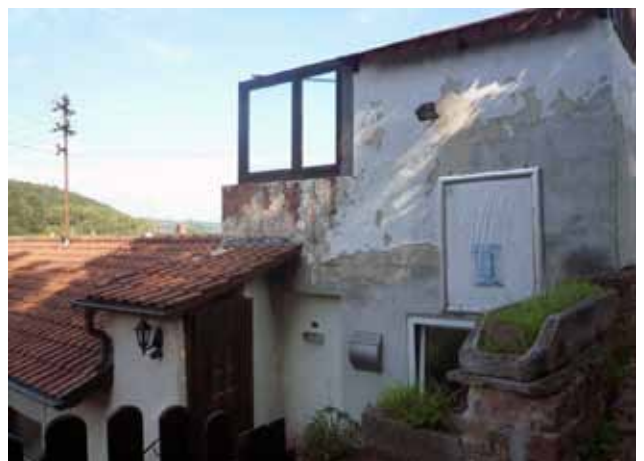
Abb. 17 Bausubstanz in schlechtem Erhaltungszustand
