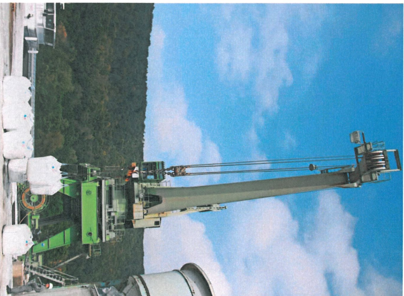
Mit dem Kran werden zwei je eine Tonne schwere Säcke mit Glasmineralen entladen. Der Kran kann bis zu 20 Tonnen heben. Fotos: Matthias Schütte
